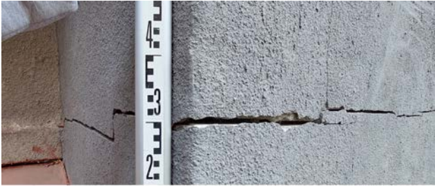
Рис. 13. Деталізація руйнування на добудованих сходах
