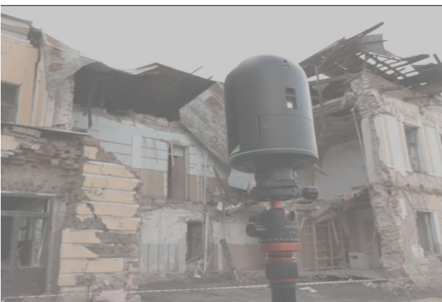
Рис. 4. 3D-сканер роботизований прилад, що фіксує ступінь пошкодження історичної будівлі
